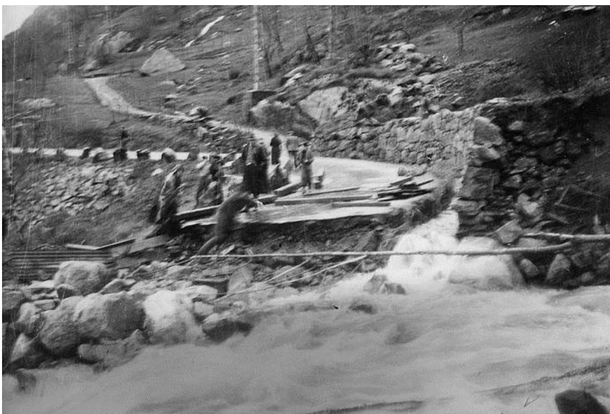
Figur A3. Flommen gjorde skade på Tyssedalsvegen, boliger nær elva og på kraftlinja fra Tyssedal, noe som medførte stopp i kraftlevering i ei uke (© NVIM, 2017).
