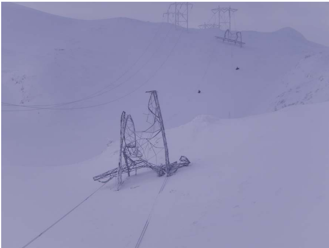
Figur 4: Mastene som havarete. Mast 330 nærmest og mast 329 på andre siden av kløft.
